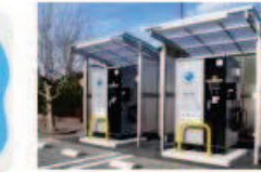
蓄電池・充電施設
