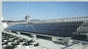
屋上 ソーラーパネル
