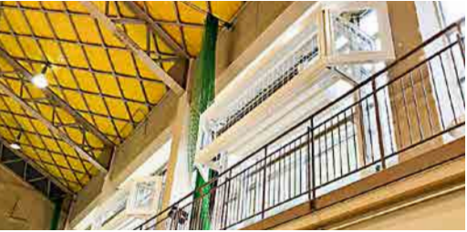
高屋中学校の体育館に設置された空調機
