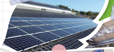
太陽光発電設備
