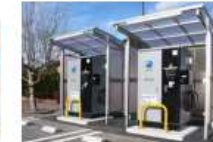
蓄電池・充電施設
