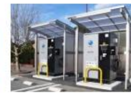
蓄電池・充電施設
