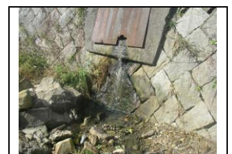
生活排水の流入部
