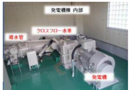
小水力発電設備 (東広島浄化センター)
