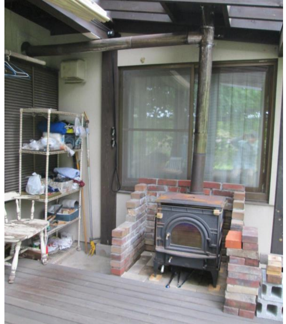
ベランダに設置した旧薪ストーブ 前面の鉄板の留めねじが破損したストーブを補強し、ストーブ設置台を作成してベランダに設置。煙突は、室内のストーブと連結。春～秋に料理用として使う予定。
