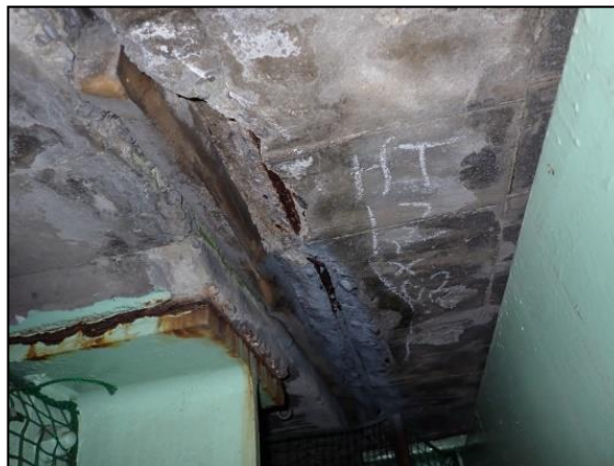
鉄筋の腐食が進み剥落のおそれがある床板
