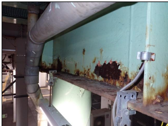
鋼材部分（橋桁）の腐食状況
