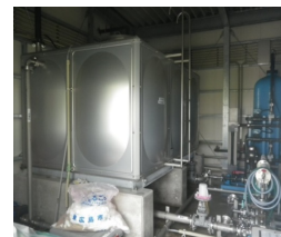
豊栄 専用水道施設
