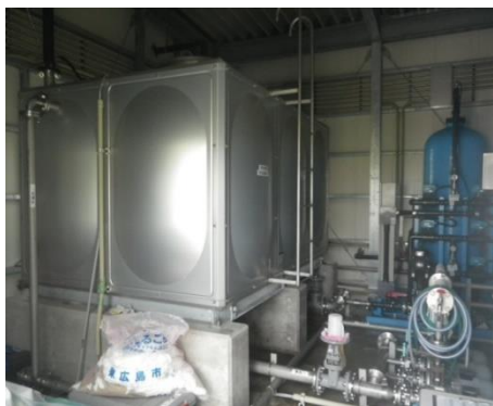
豊栄 専用水道施設
