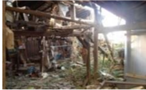
<老朽危険空家事例> ※出典国土交通省HPより
