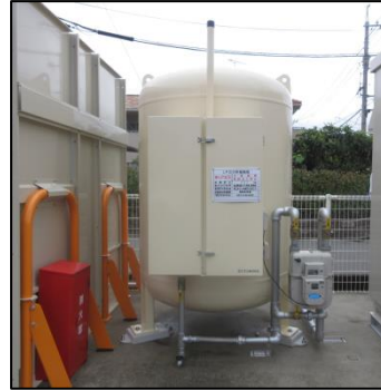
LP ガス貯蔵施設
