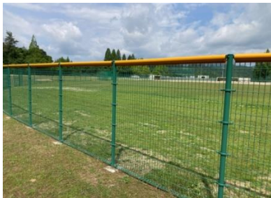
志和市民グラウンド防球フェンス
