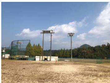
照明灯（志和市民グラウンド）
