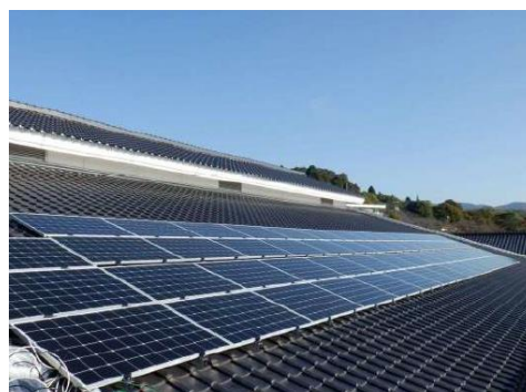
太陽光発電設備
