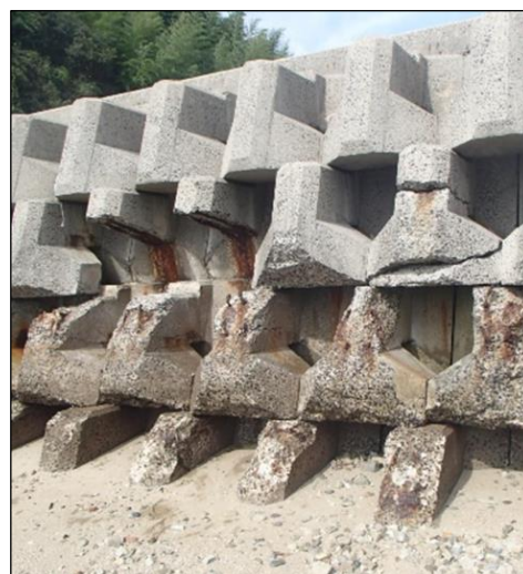
消波ブロックの破損
