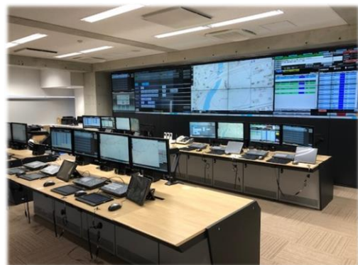
【高機能消防指令センター】
