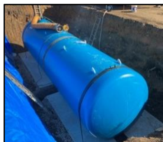
【防火水そう (FRP)】
