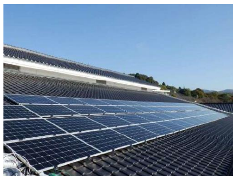
太陽光発電設備
