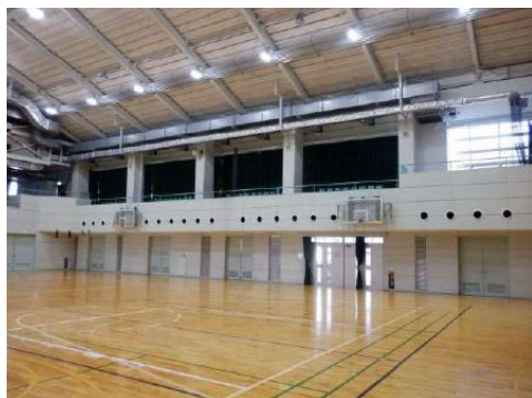
屋内運動場空調設備
