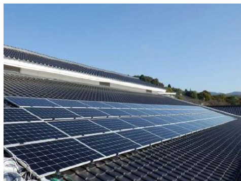
太陽光発電設備
