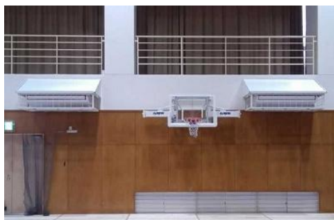
屋内運動場空調設備
