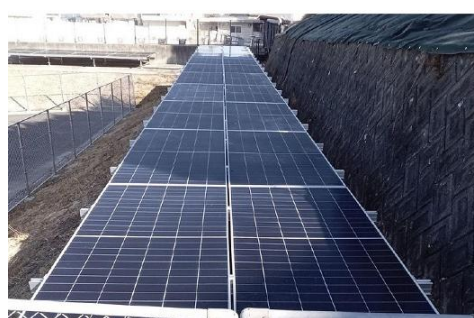
太陽光発電設備
