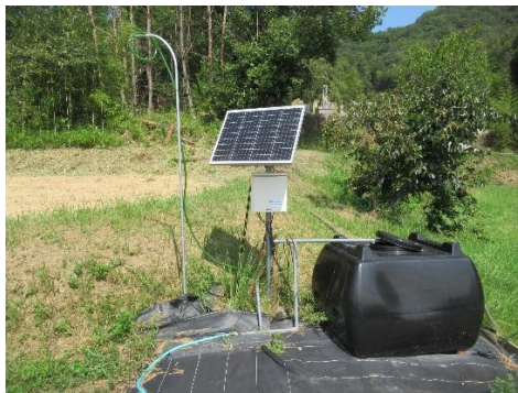
現地に導入された自動給液装置
