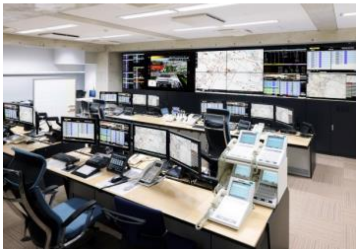
【高機能消防指令センター】
