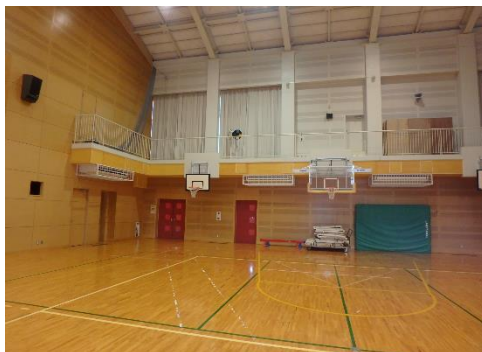
屋内運動場空調設備
