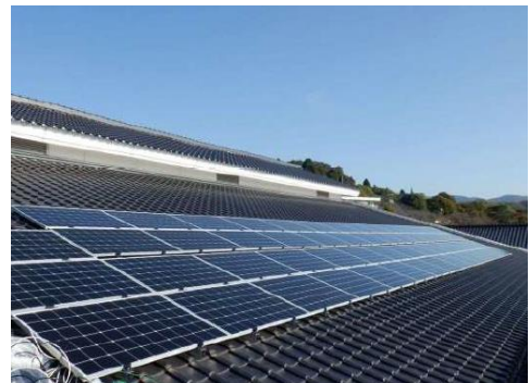
太陽光発電設備
