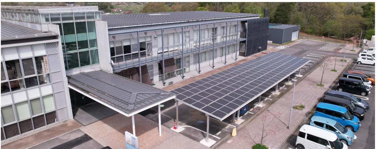
太陽光発電システム
