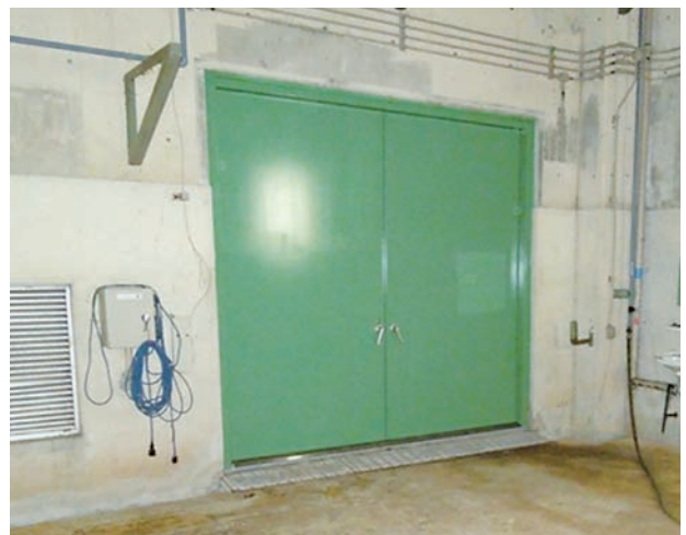
【処理場】東広島浄化センター (ポンプ棟水没により扉破損)
