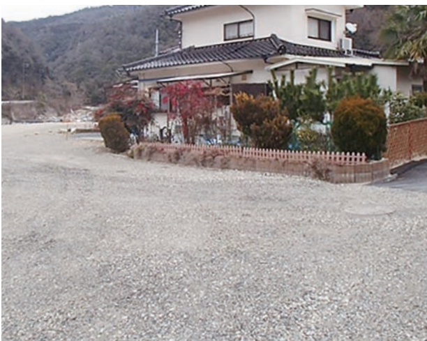
【管路施設】河内処理分区 (河川護岸崩壊により汚水管路損壊)
