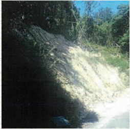
風早地区 法面崩壊 (椀ノ丘線)
