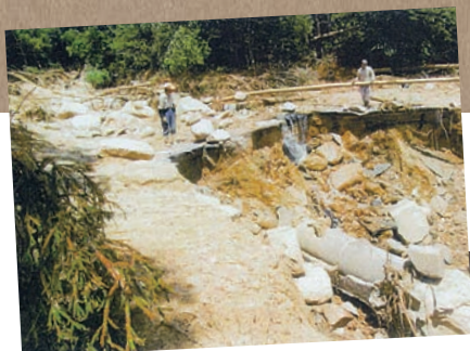
王司ヶ谷林道(用水路)の被害状況
