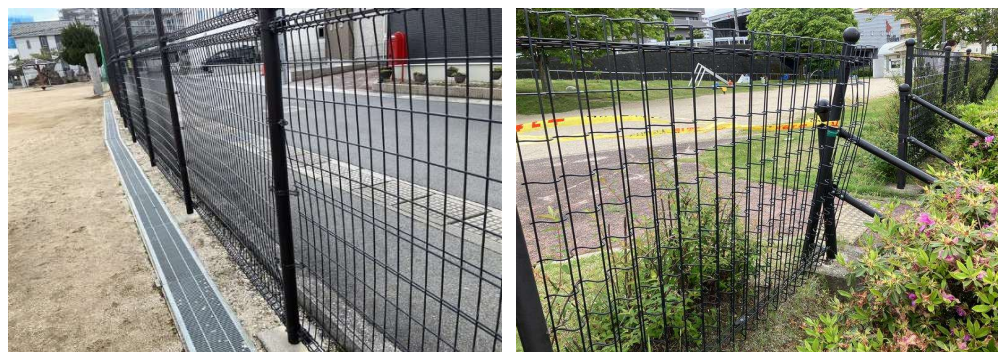
フェンスの破損
