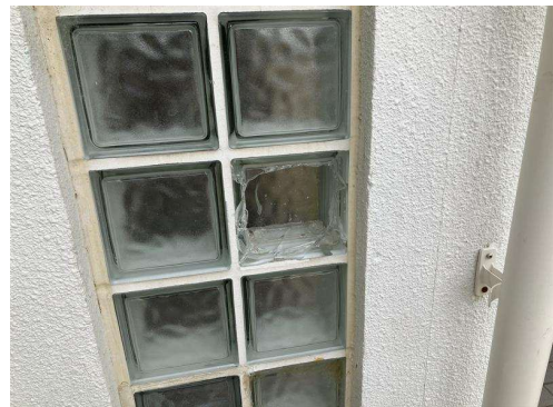
ガラスの破損
