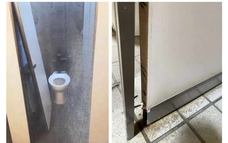
トイレドアの破損
