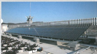
屋上 ソーラーパネル
