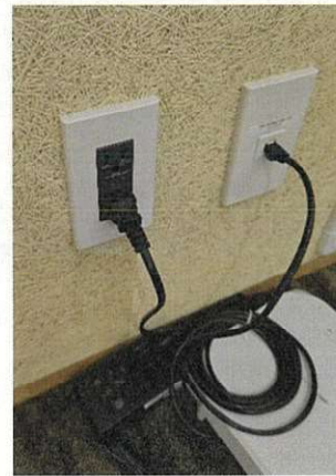
非常用コンセント (小清水町役場)
