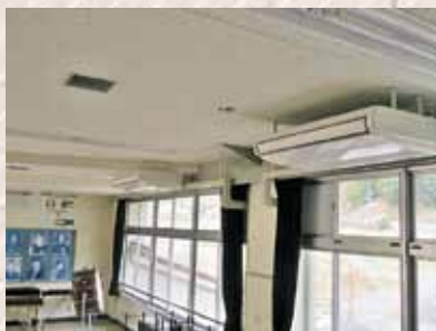
音楽室に設置されたエアコン
