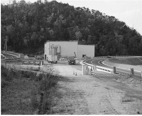
防音ハウス内で整備が進む安芸バイパス大山トンネル
