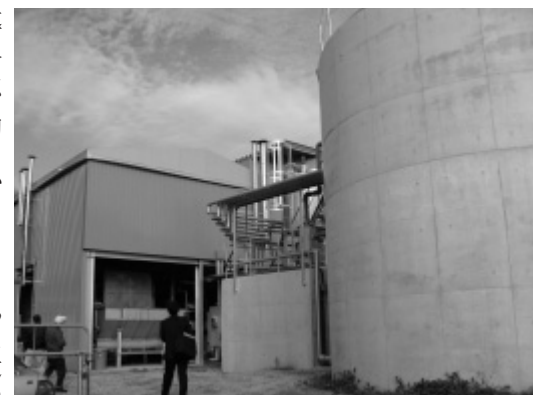
バイオマスを効率的にエネルギー化する広島大学の施設
