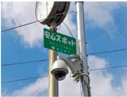
東広島駅設置の防犯カメラ
