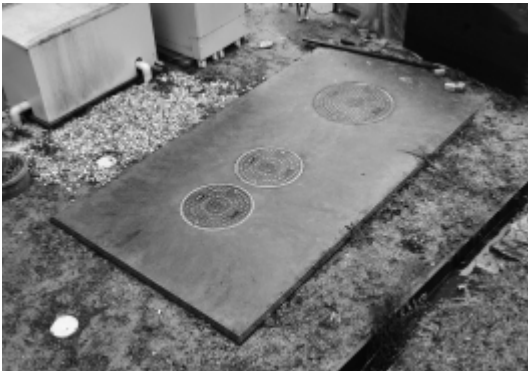
住宅に設置された小型合併浄化槽
