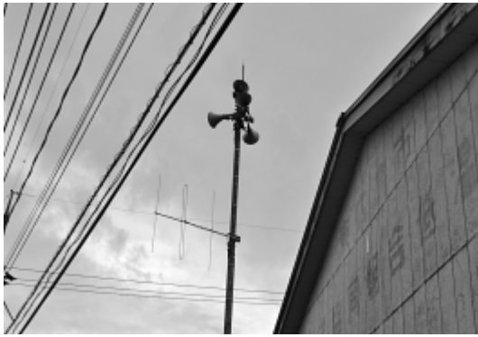
防災行政無線施設
