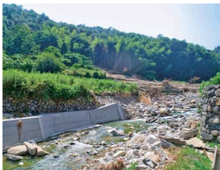
河川被災状況
