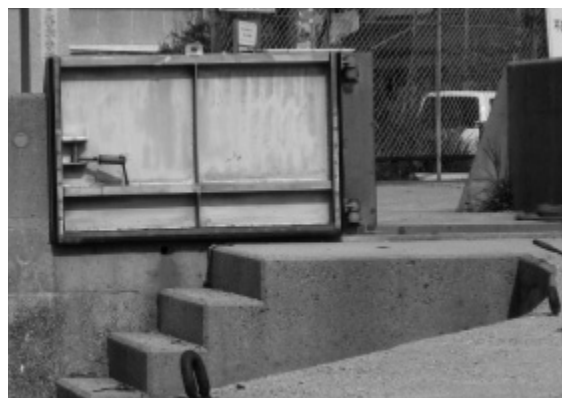
高潮被害を防ぐための防潮扉
