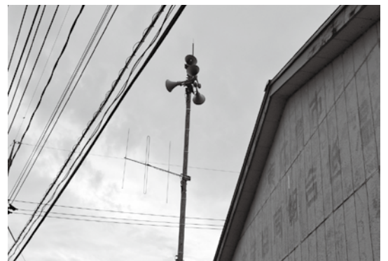
防災行政無線の屋外放送施設
