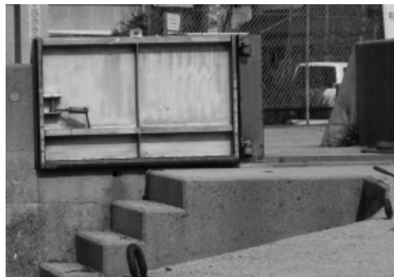
高潮被害を防ぐための防潮扉
