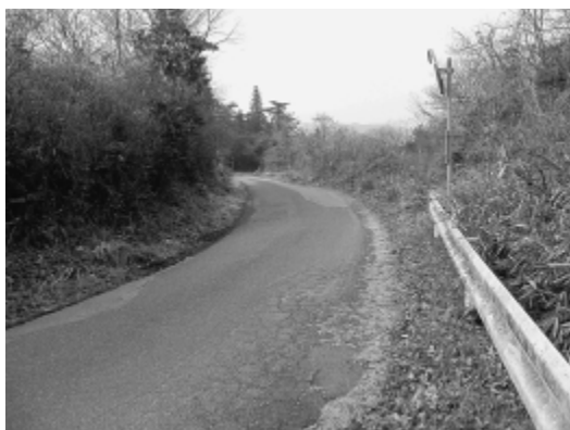
幅員が狭く、カーブの多い市道大沢大河内線
