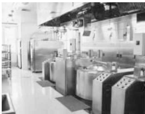
西条学校給食センターのドライシステム
