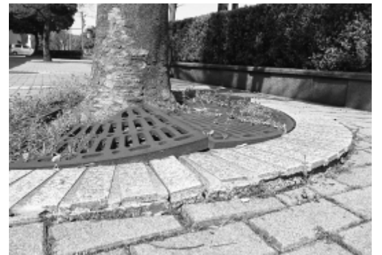
樹木の根で隆起しているブルバール
