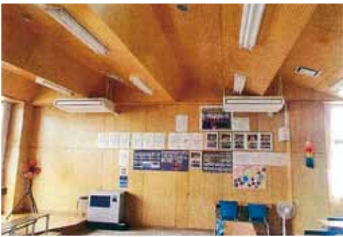
音楽室に設置されたエアコン
