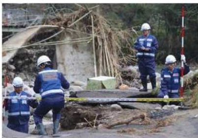
10月22日 茨城県日立市における道路施設の被災状況調査【中国地整・道路班】
