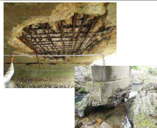
道路施設の老朽化
