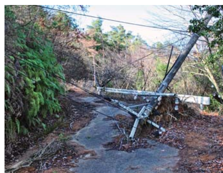
被災した道路
