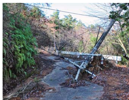
被災した道路
